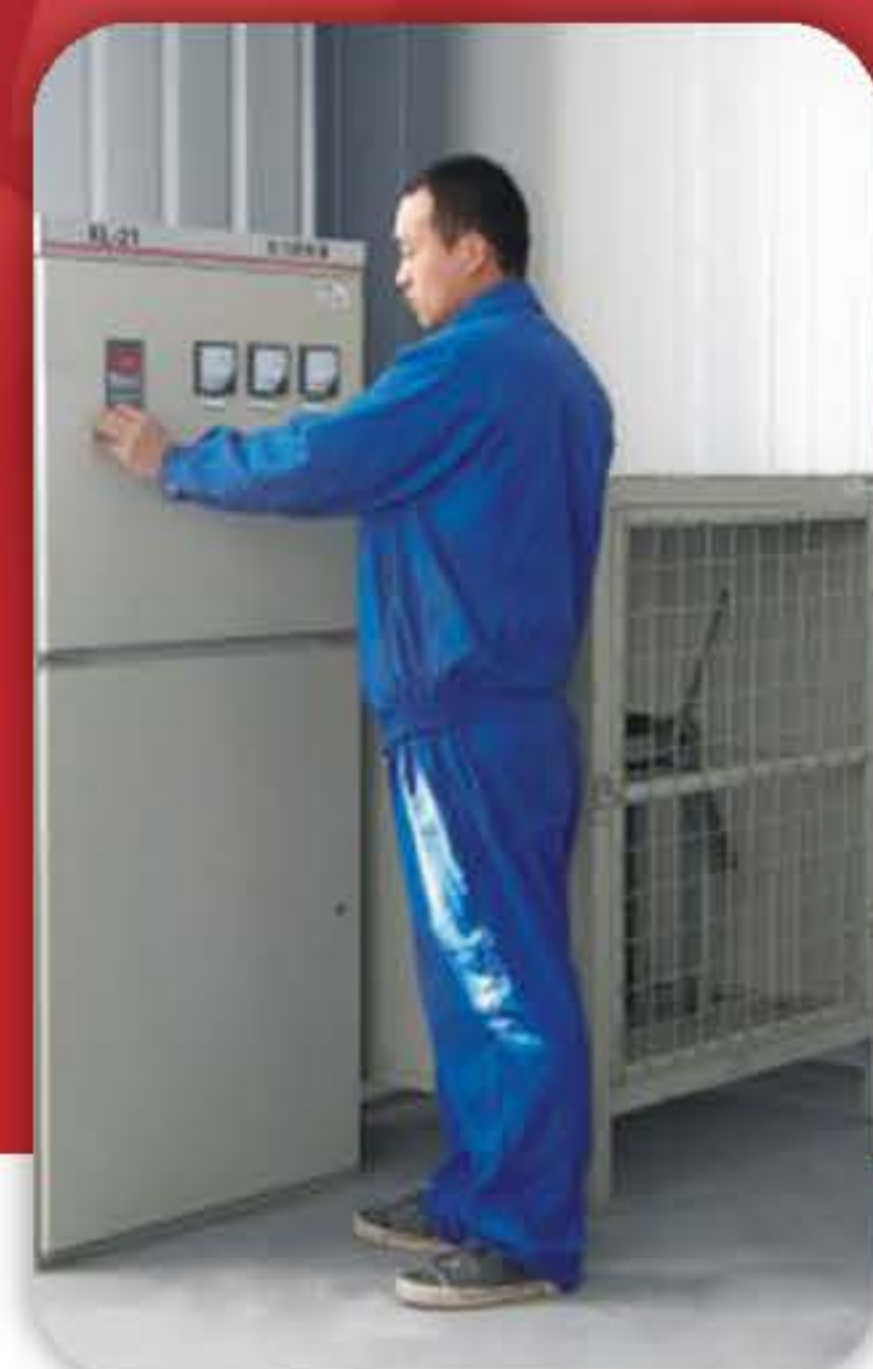
Fan speeding test
